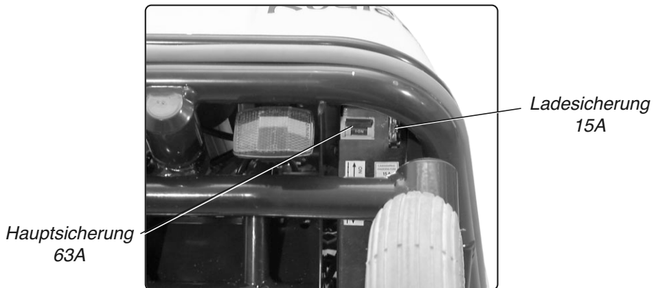
Abb 7. Hauptsicherung und Ladesicherung.
