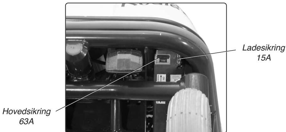
Billede 7. Hovedsikring og ladesikring.
